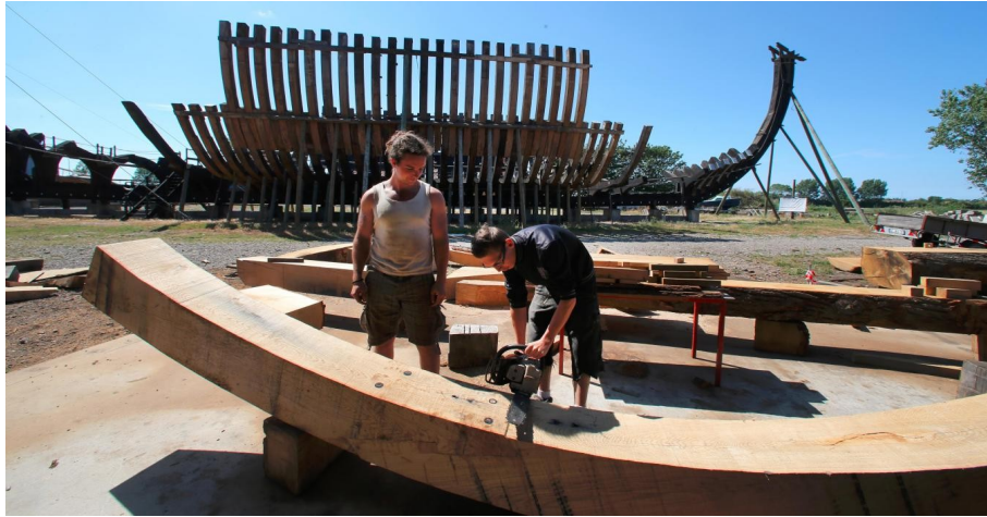
Le chantier Tourville vise à construire, avec les techniques de l'époque, le vaisseau du XVIIe siècle le « Jean Bart ».
